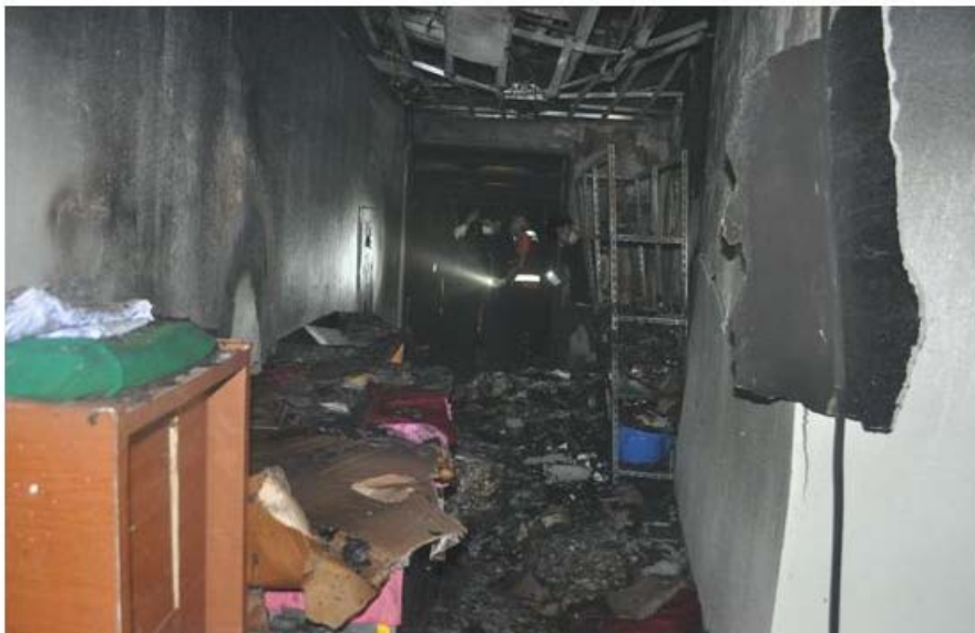
서귀포시내 모 호텔 화재 피해 현장 모습. /사진=서귀포소방서
